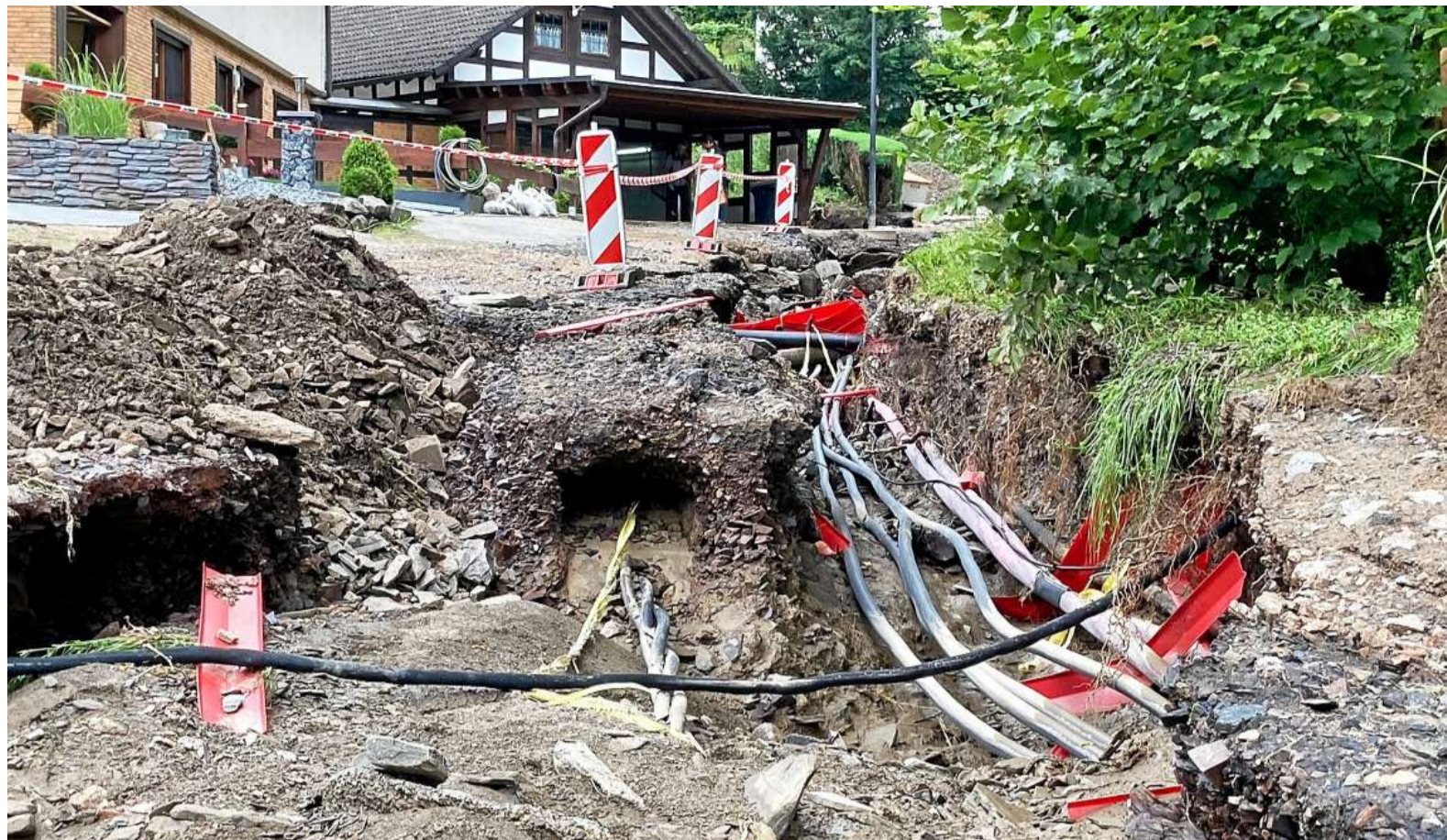
Der Holunderweg in Oedingen am 15. Juli, ein Jahr nach dem Starkregenereignis. Das Wasser hat den Weg komplett zerstört.
